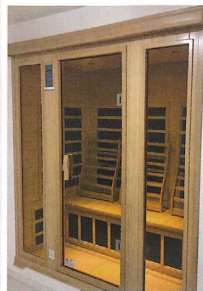
導入したサウナ設備
